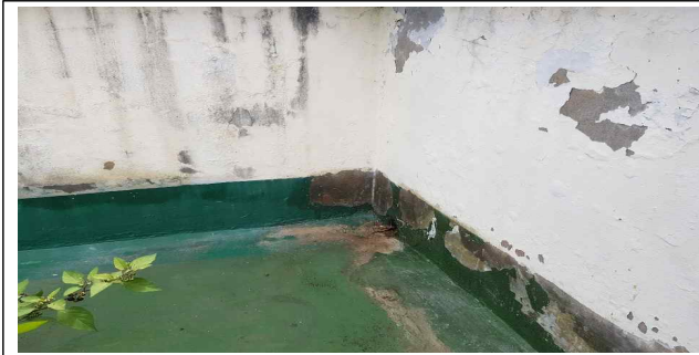
(옥상 외벽 및 바닥 갈라짐)
