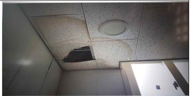
(2층 남,여 화장실 누수)
