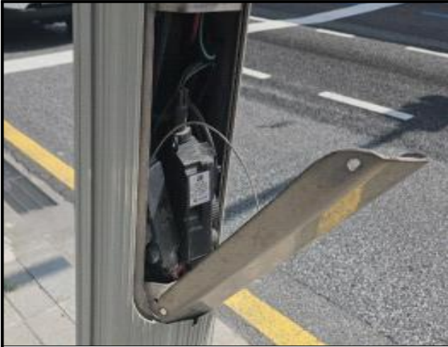
노후 가로등(점검구 및 배선상태)
